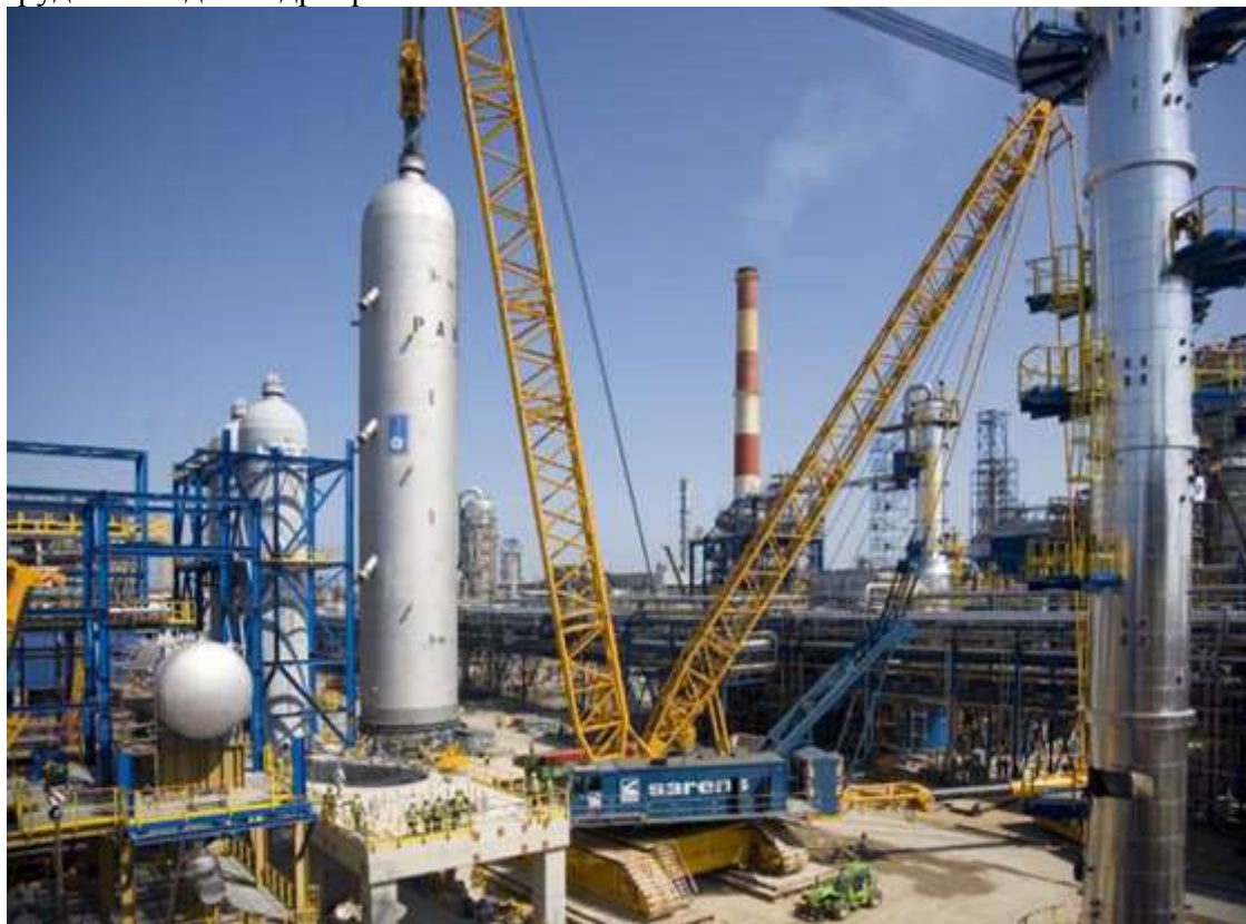
Оборудование для гидрокрекинга.
